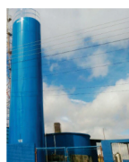
Figura 03 - Reservatório R3 - Remota
