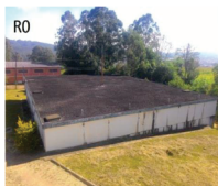
Figura 02 - Reservatório R0 - ETA Matarazzo
